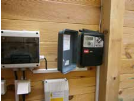
Zavlažovací systém – riadiaca jednotka
